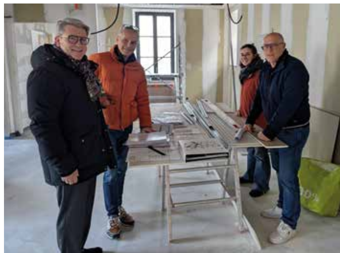
Le sous-préfet M. ROBQUIN (à gauche), lors de sa visite du chantier, en compagnie de M. POULET, architecte, de son assistante et de M. le Maire
