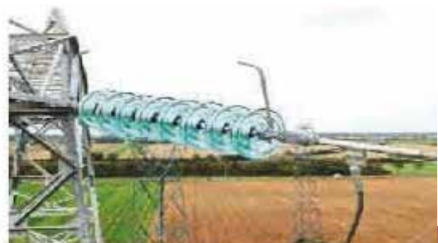
inspection électrique en hauteur
